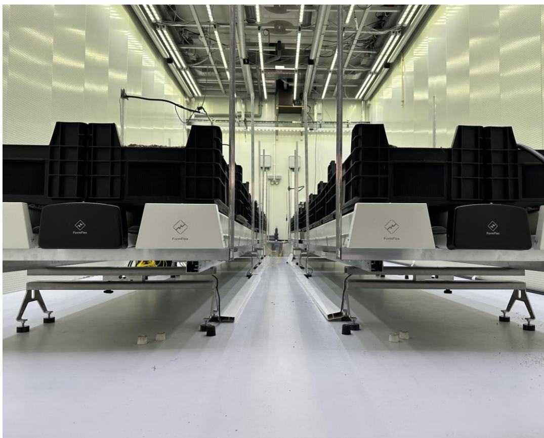
Figuur 2.3. Een impressie van de weegschalen waarmee de verdamping over de tijd kon worden bijgehouden. Elk kraanvak bevatte twee weegschalen (4 sets van 2 (= 8) weegschalen per klimaatcel) waar de gehele teeltconstructie op rust.
