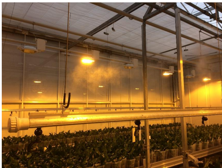
Foto 4. In de proefkassen was verneveling aanwezig, zeker in de opkweek stond deze veelvuldig aan vanwege het feit dat de proefkassen vrij droog waren. Er zijn bevoeiingsmatten op grond gelegd om het gebruik van de vernevelaar te verminderen.
